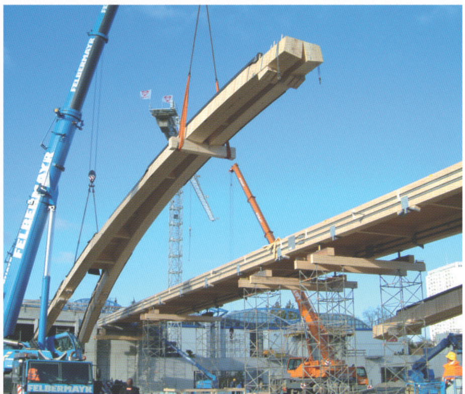
Bild 6 Anheben einer Bogenpaar-Hälfte. Gut erkennbar: Der Kontaktstoß im Scheitel und im Hintergrund die Stahlzugbänder in den seitlichen Nuten des waagerechten Längsbalkens.
