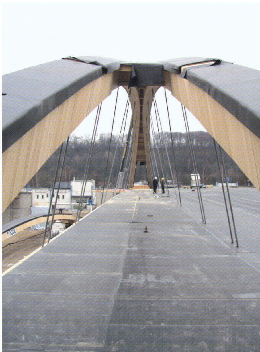
Bild 9 Die erste Abdichtung war – weitgehend werkseitig aufgebracht – schnell geschlossen. Die Einhausung der Bögen muss noch komplettiert werden. Auf zum nächsten Bogen, der unten anrollt.
